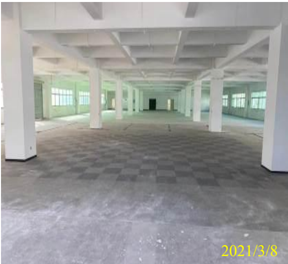
项目车间状况
