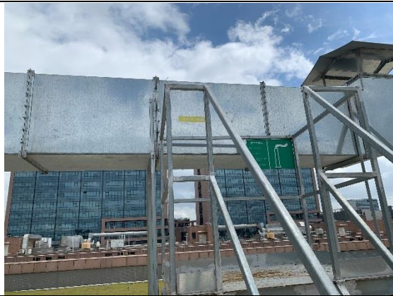
项目焊接废气排放口标识
