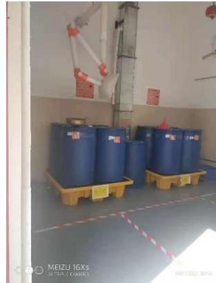
项目危险废物贮存场所标识
