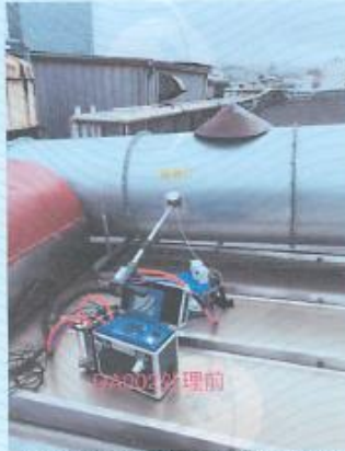
DA002 注塑废气处理前检测口 G9
