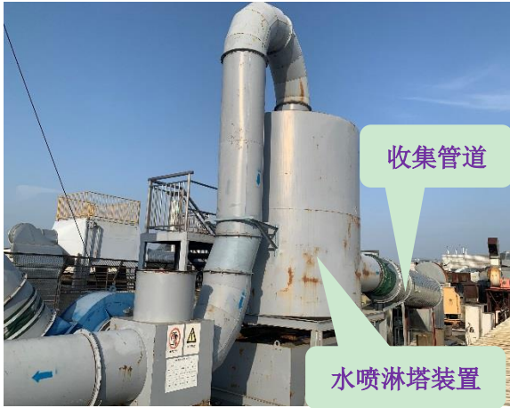
废气治理设施
